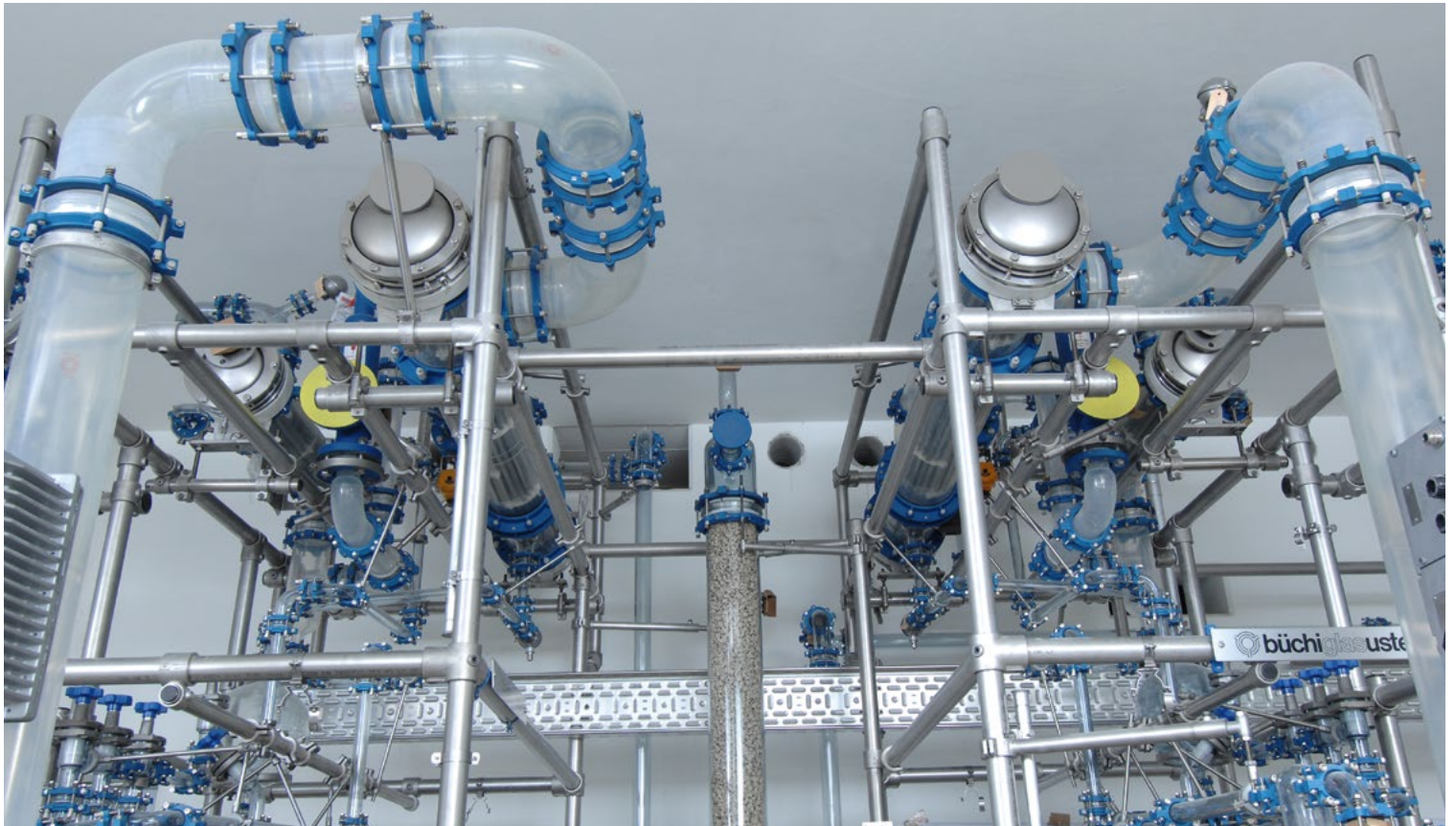
Distillation overhead with SIC shell and tube heat exchangers Destillationsaufbau mit SIC Rohrbündelwärmetauschern
